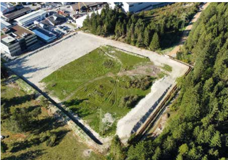
Die neue Schottergrube „Woade“ inkl. neuer „Trimm Dich Pfad“ – Eigentümer: Fraktion Gais, verpachtet an die Firma BWR.
